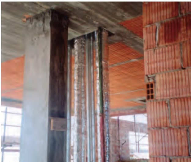
Cavedi (piano terra) con condotte dell'aria proveniente dalla pompa di calore posta al piano interrato.
